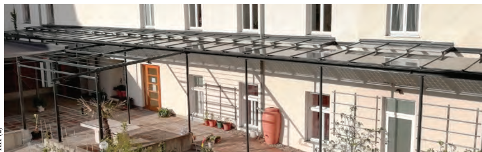
Die Photovoltaikanlage im Pfarrergarten liefert schon Strom.
